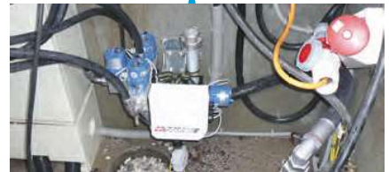
2013: Das sehr kompakte Kombi-Schachtventil KSV wurde speziell für den Einsatz mit NESSy - und SnoTek -Lanzen entwickelt.
