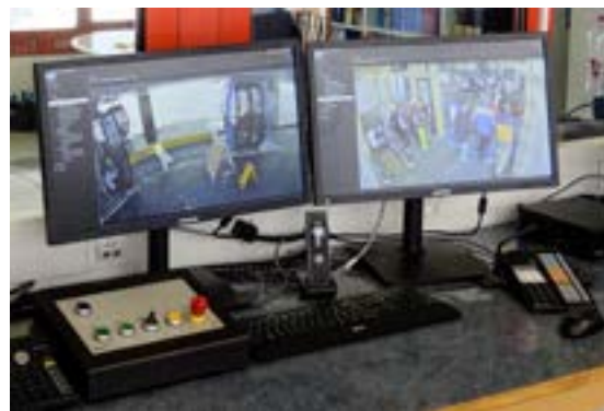
Das ROC befindet sich für diese Anlagen auf dem Blauerhd im Bürokomplex des technischen Leiters.
