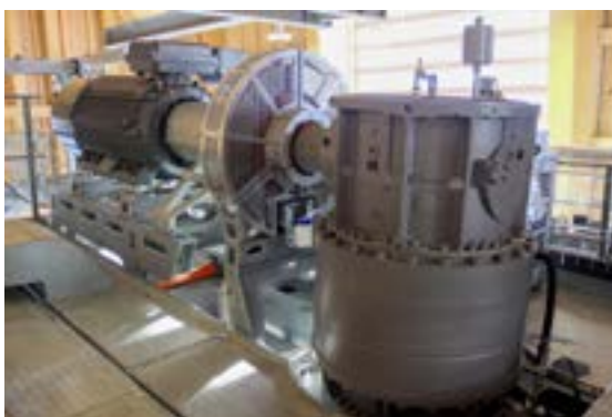
Der ABB Motor in der Talstation Tuftern erzeugt eine Leistung von 583 kW.
