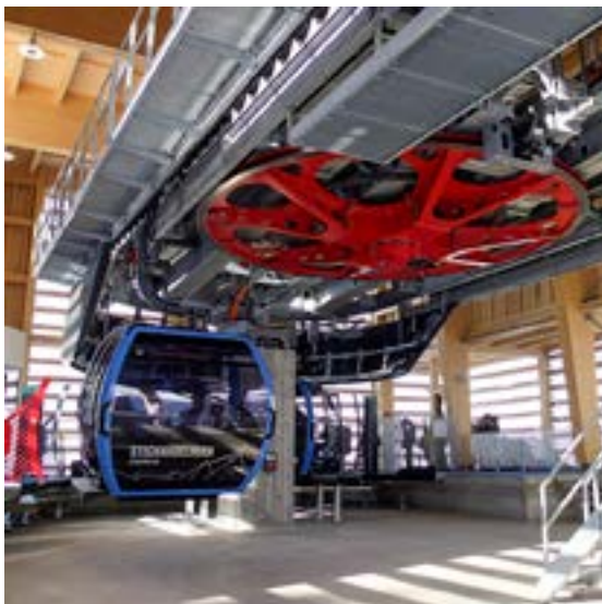
Sensoren überwachen die Perrongrube und Konturen und weisen den Fahrgästen den Weg sicher in die Fahrzeuge.
